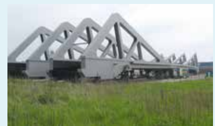
Die Stahlkonstruktion der vier Klappen wurde auf einem Vormontageplatz in Wilhelmshaven vormontiert.
